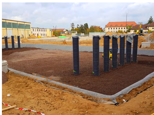
Fig. 67 : Les couches inférieures sont constituées d'éléments en plastique (utilisation comme eau d'extinction) et les autres couches, de lave (espace poral élevé)
