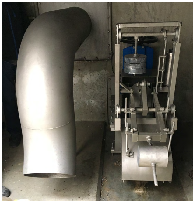
Fig. 80 : À droite, le régulateur de débit, et à gauche, le trop-plein du volume de rétention.
