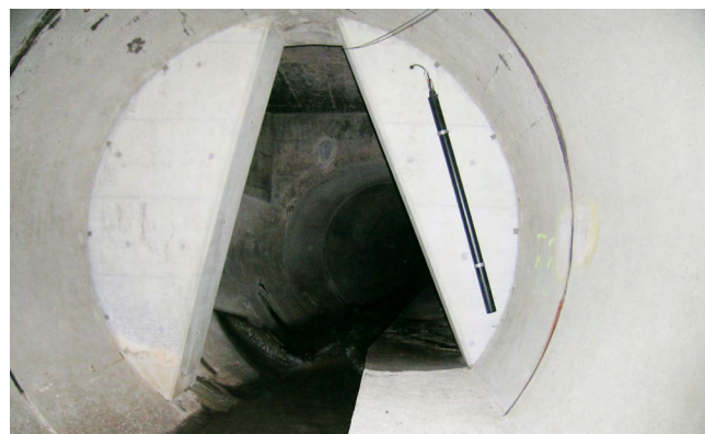
Fig. 72 : Canal d'amenée à Köniz avec dispositif de régulation. Le tube noir contient une sonde destinée à mesurer le niveau d'eau
