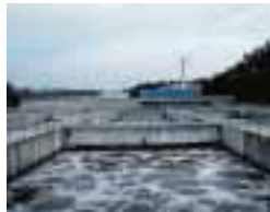
ÉPURATION DES EAUX
