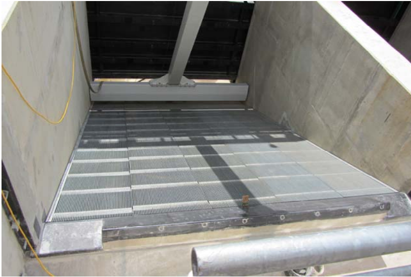
Bild 6: Pilotanlage Unkelmühle / Sieg: 10 mm-Rechen mit vertikalen Rechenstäben, ca. 30° gegen die Sohle geneigt mit oben liegender Spülrinne, als Bypass für die oberflächennahe Abwanderung.
