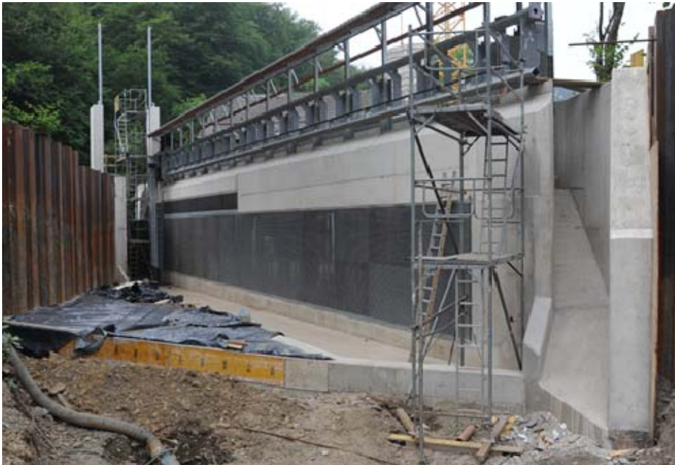
Bild 4 Horizontalrechen mit lichtem Rechenabstand von 12 mm an einer Wasserkraftanlage mit einem Ausbaudurchfluss von 16 m 3 /s
