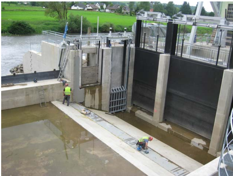
Bild 7 Pilotanlage Unkelmühle / Sieg: Neue Doppelschütze vor der Rechenanlage.
