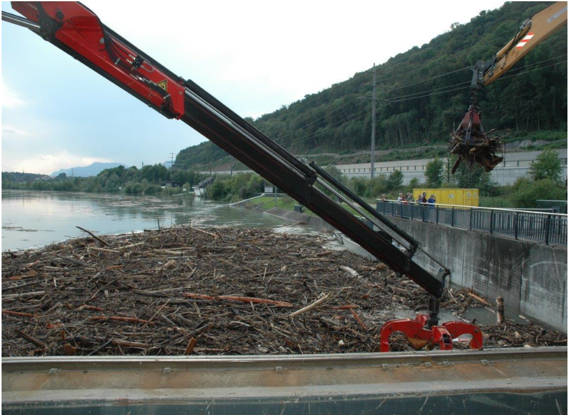
Schwemholzentnahme am KW Ruppoldingen an der Aare während Juli-Hochwasser 2014, Quelle: Alpiq
